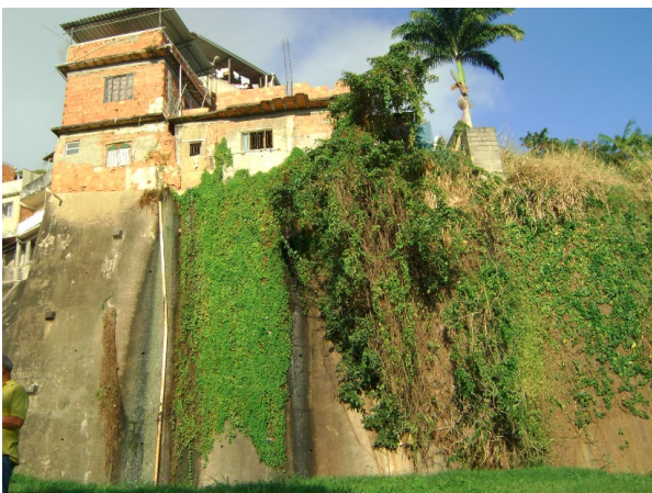
Figura 6.20 Contenciones en concreto con necesidad de tratamiento superficial y en juntas
