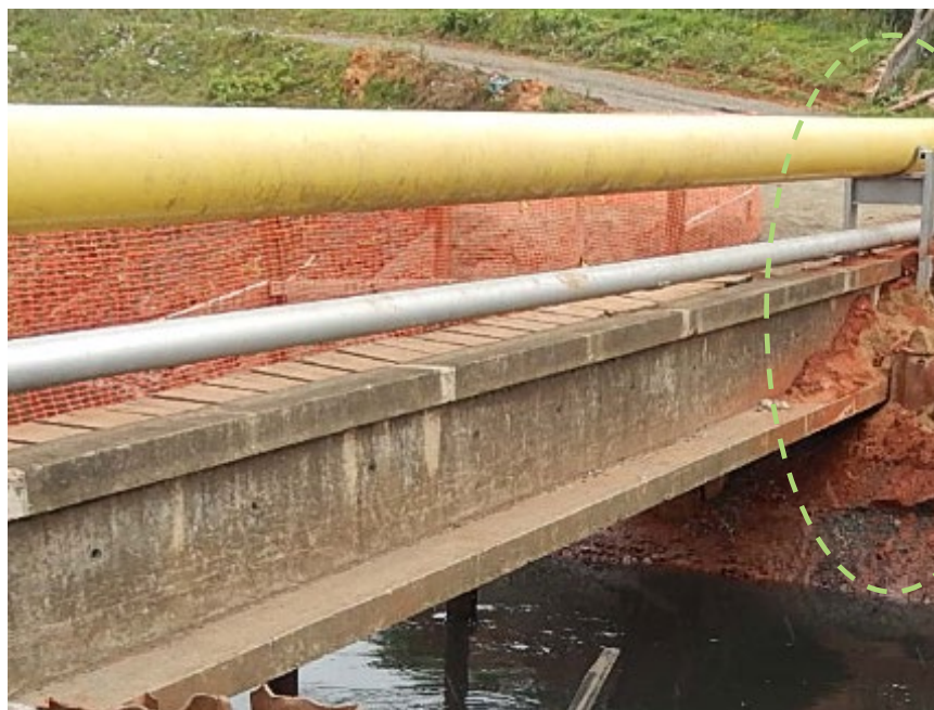
Figura 6.32 Cruce aéreo con pérdida de soporte debido a la ruptura de cimientos de la viga
