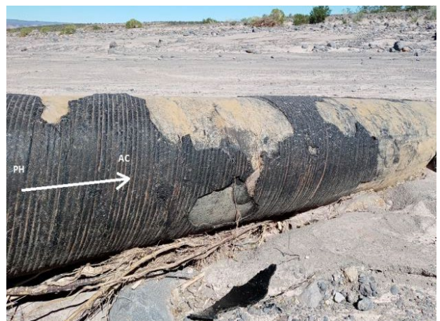
Figura 9.47: Daños en ducto expuesto
