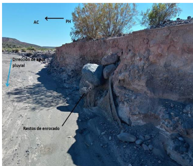
Figura 9.43: Resto de la protección antigua.
