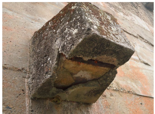
Figura 6.25 Cabezal de protección sin la correcta intercomunicación con el panel de la cortina, ni con argamasa resistente que propicie pasivado del herraje
