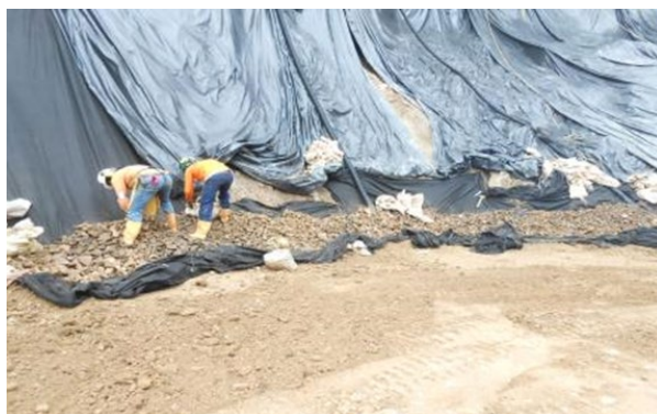
Figura 9.35 Filtro chimenea con geotextil y material pétreo en la cara interior del muro
