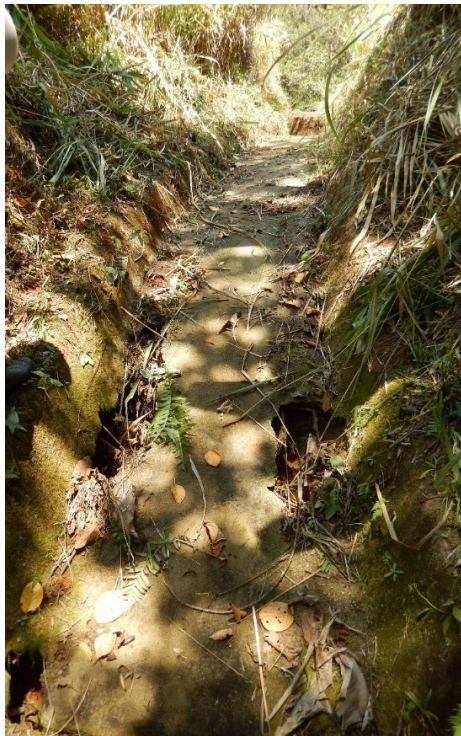
Figura 6.7 Daños en la base del drenaje e instauración del proceso de erosión
