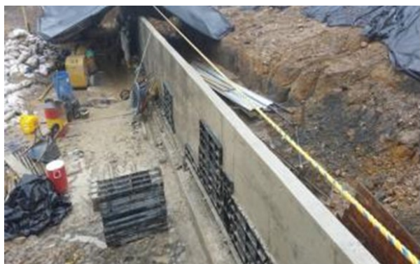
Figura 9.34 Muro de concreto reforzado construido en la base del muro de geosintético.
