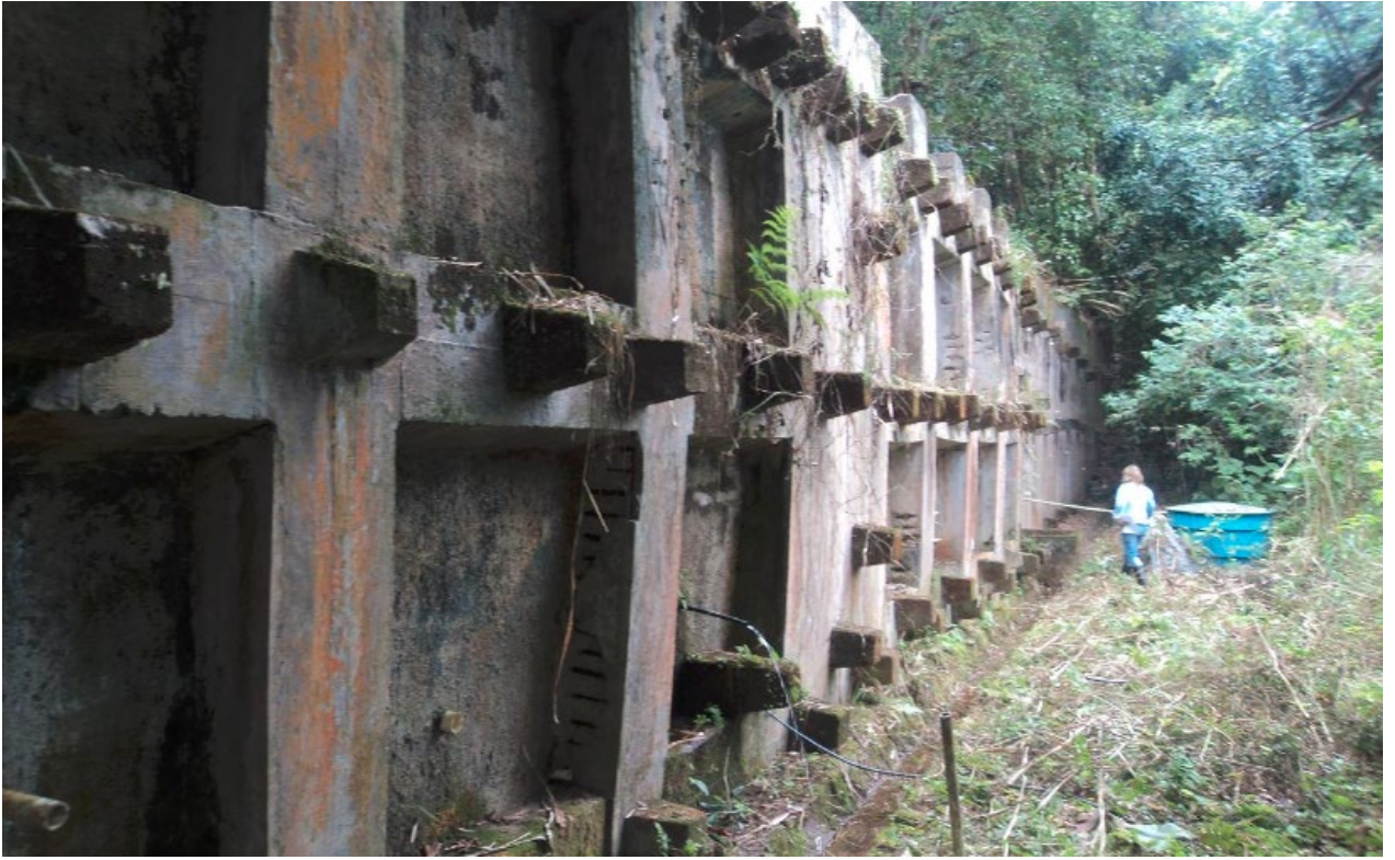
Figura 6.21 Estructura con armadura expuesta con necesidad de tratamiento anti-oxidación y recubrimiento con argamasa de reparación estructural
