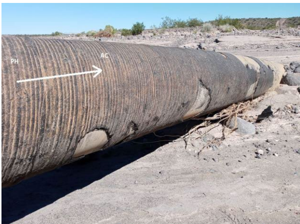
Figura 9.46: Daños en ducto expuesto
