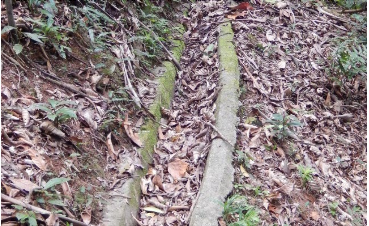
Figura 6.2 Cuneta obstruida por falta de limpieza periódica
