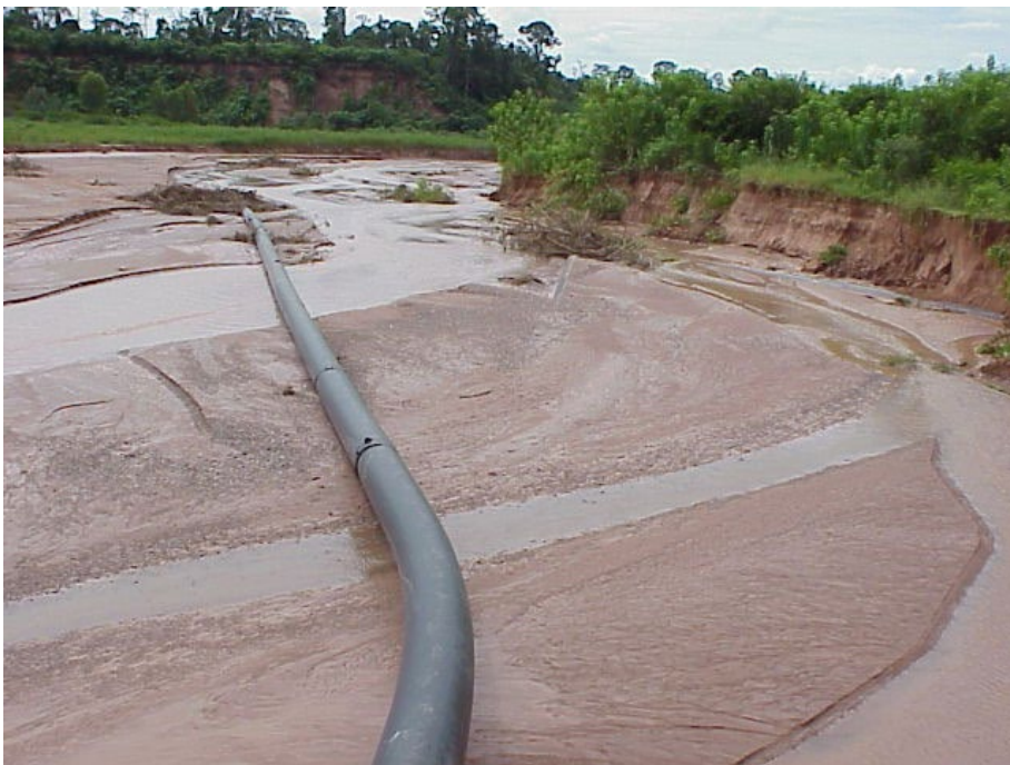
Figura 4.23 Erosión lateral con ducto descubierto y parcialmente apoyado en un río caracterizado por meandros
