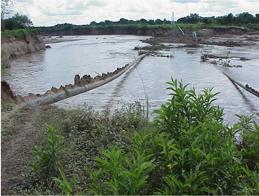
Figura 4.22 Erosión de margen resultando en ducto sin apoyo luego de una crecida en un río de régimen intermitente
