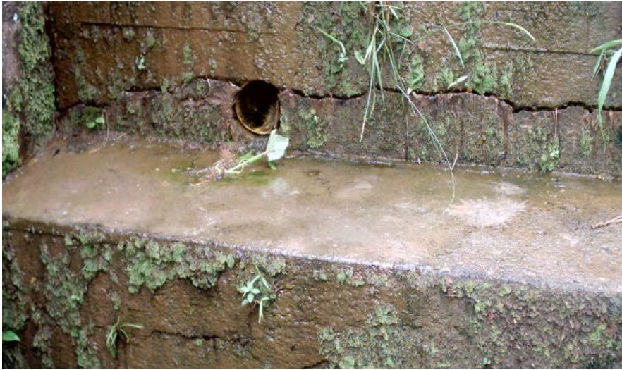
Figura 6.6 Escalera con concreto en principio de deterioro por falta de armadura y porosidad
