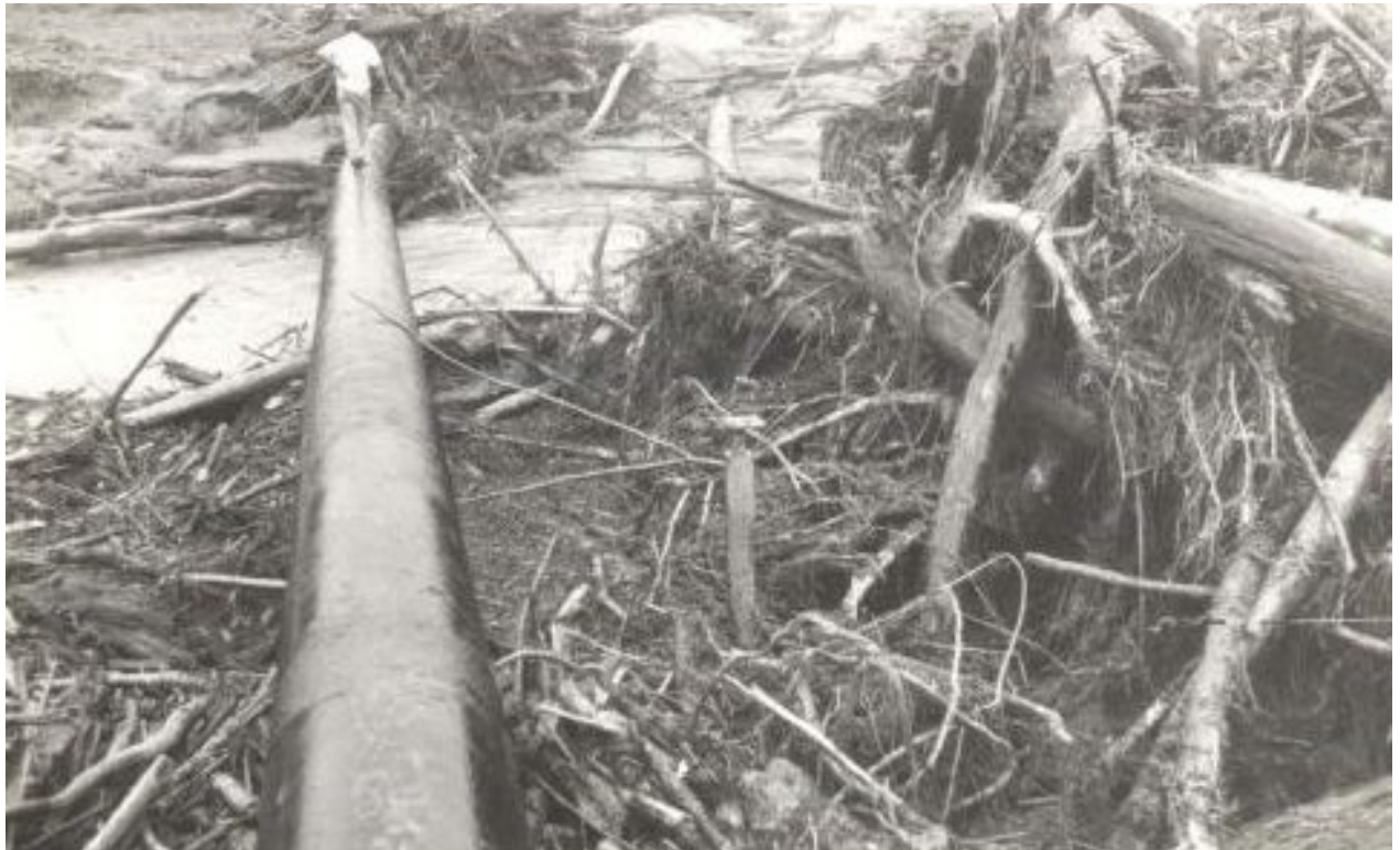
Figura 4.30 Impacto de troncos y ramas en ductos expuestos en un río de piedemonte
