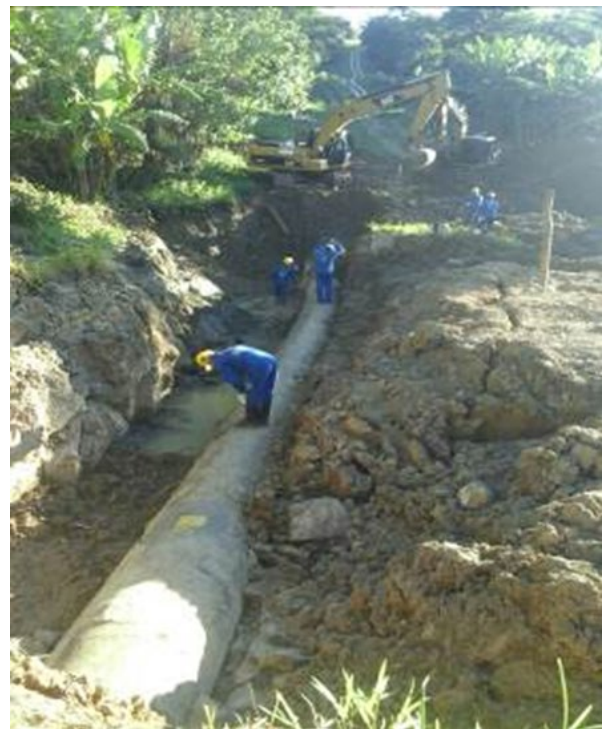
Figura 9.26 Inicio de la excavación de la zanja. Observar la deformación del ducto y las grietas en el terreno indicando el movimiento del ducto
