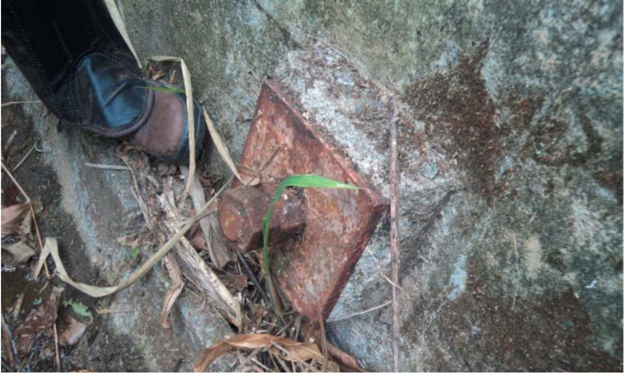
Figura 6.26 Cabeza de tirante en proceso de corrosión, con necesidad de pintura o cabezal de protección
