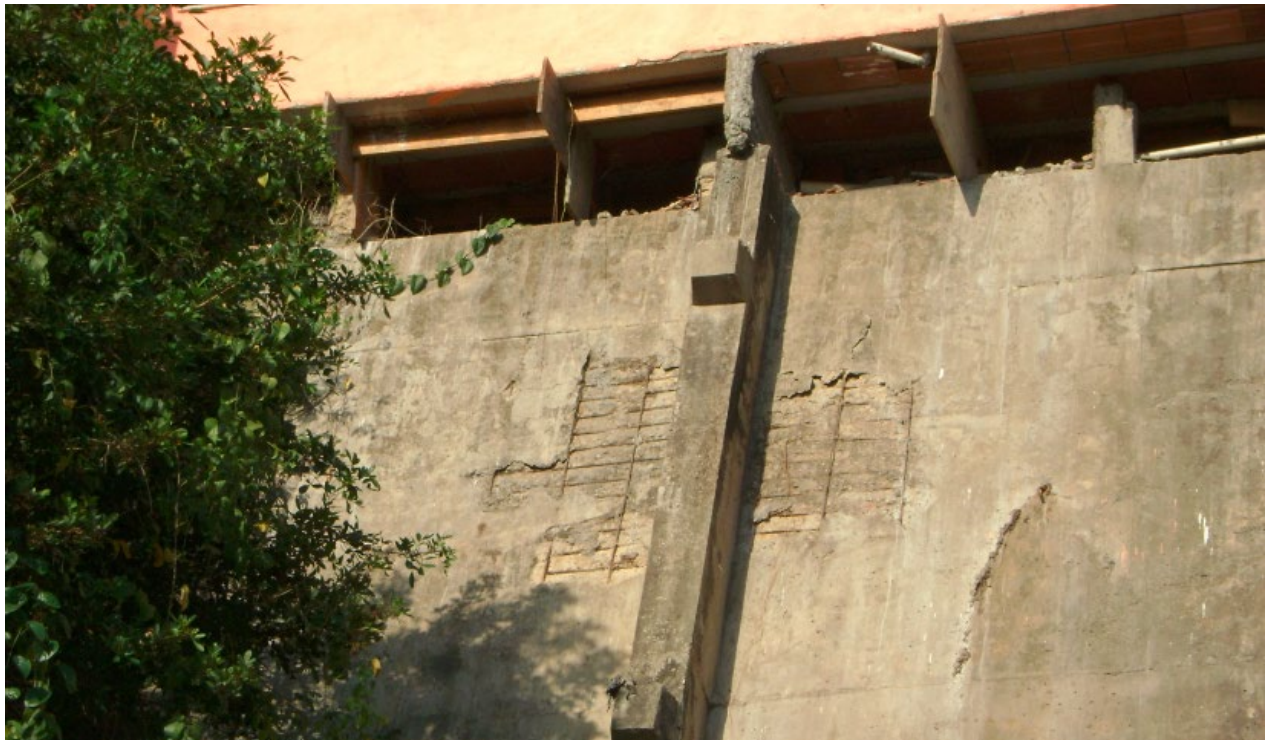
Figura 6.22 Estructura con armadura expuesta en panel, con necesidad de tratamiento anti-oxidación y recubrimiento con argamasa de reparación estructural
