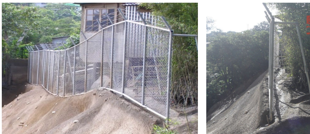
Figuras 9.13 Cuneta y malla ciclón
