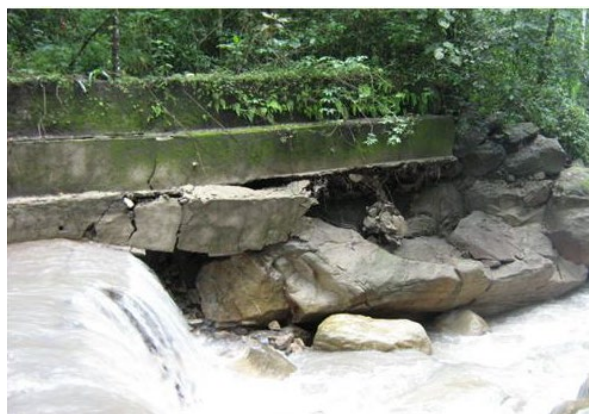
Figura 4.19: Socavación localizada -de fondo- en quebrada en el piedemonte colombiano.
