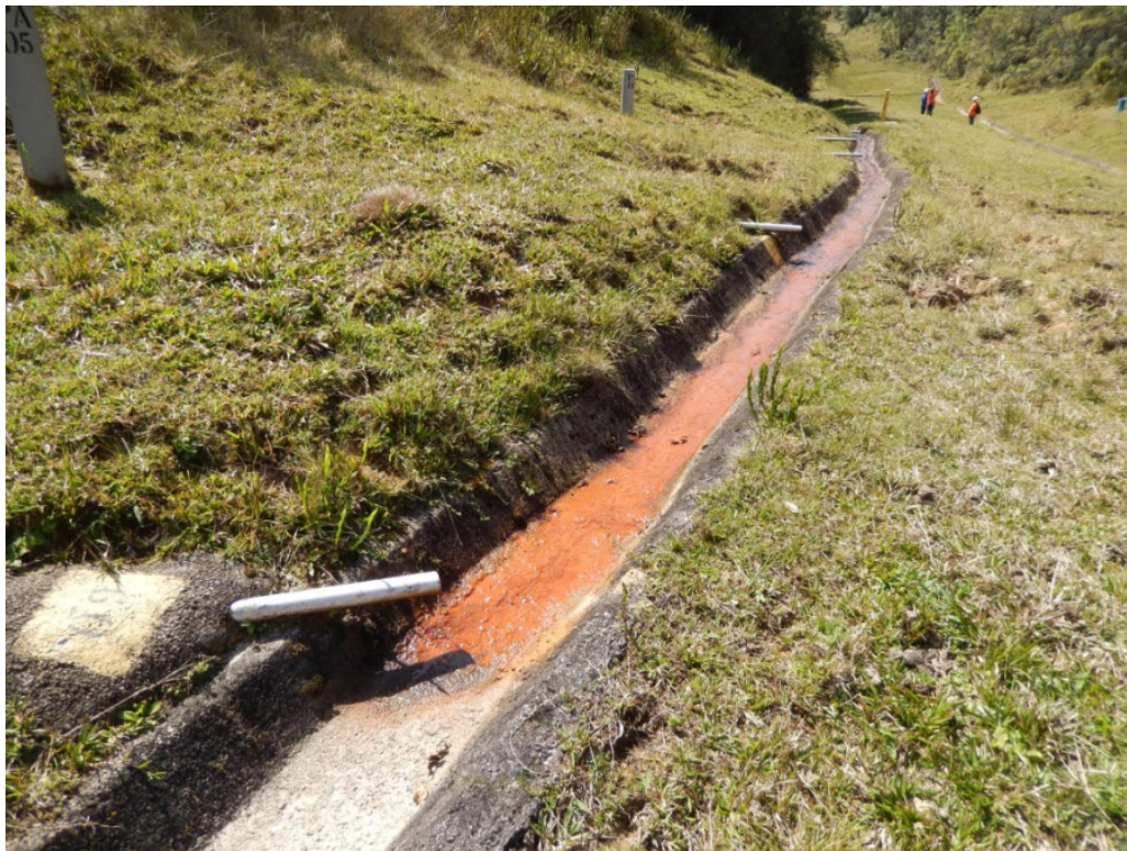
Figura 6.15 Presencia de ocre en agua drenada por el DHP.
