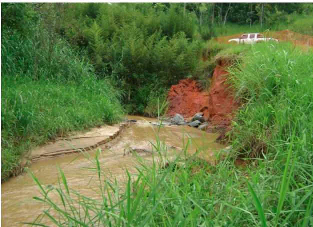
Figura 6.30 Ducto enterrado y con cobertura adecuada, con necesidad de mantenimiento preventivo en toda la orilla para evitar nuevos escurrimientos
