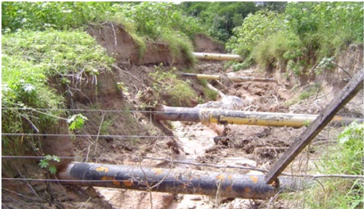
Figura 4.20: Socavación generalizada de lecho en un cruce ubicado en el piedemonte Fuente: Transportadora de Gas del Norte
