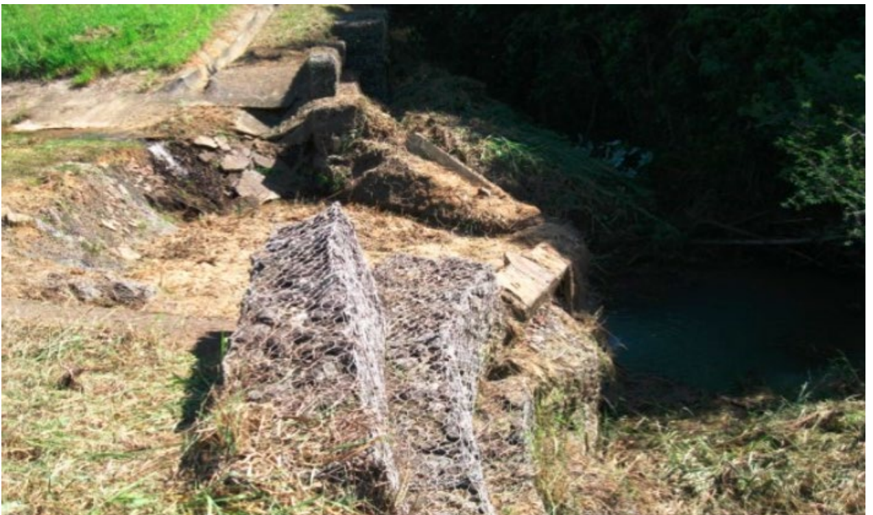
Figura 6.19 Gavión derribado debido al proceso de solapamiento de fundación, requiriendo reconstrucción como mantenimiento correctivo
