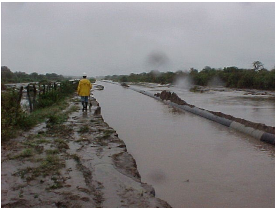
Figura 4.28 Cambio de curso por fuga por el DDV en el valle de inundación de un río cuyo cauce principal está colmatado por sedimentos
