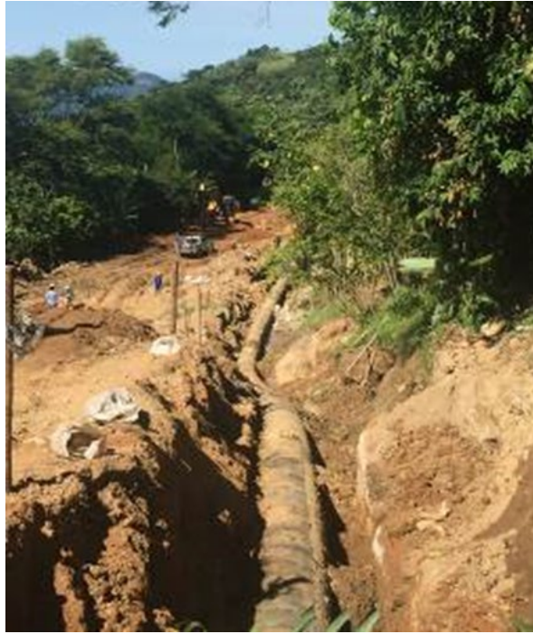
Figura 9.27 Deformación del oleoducto a lo largo de la zanja
