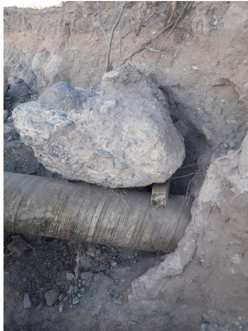
Figura 9.53: Tamaño de roca que traslado la corriente y deposito sobre el ducto
