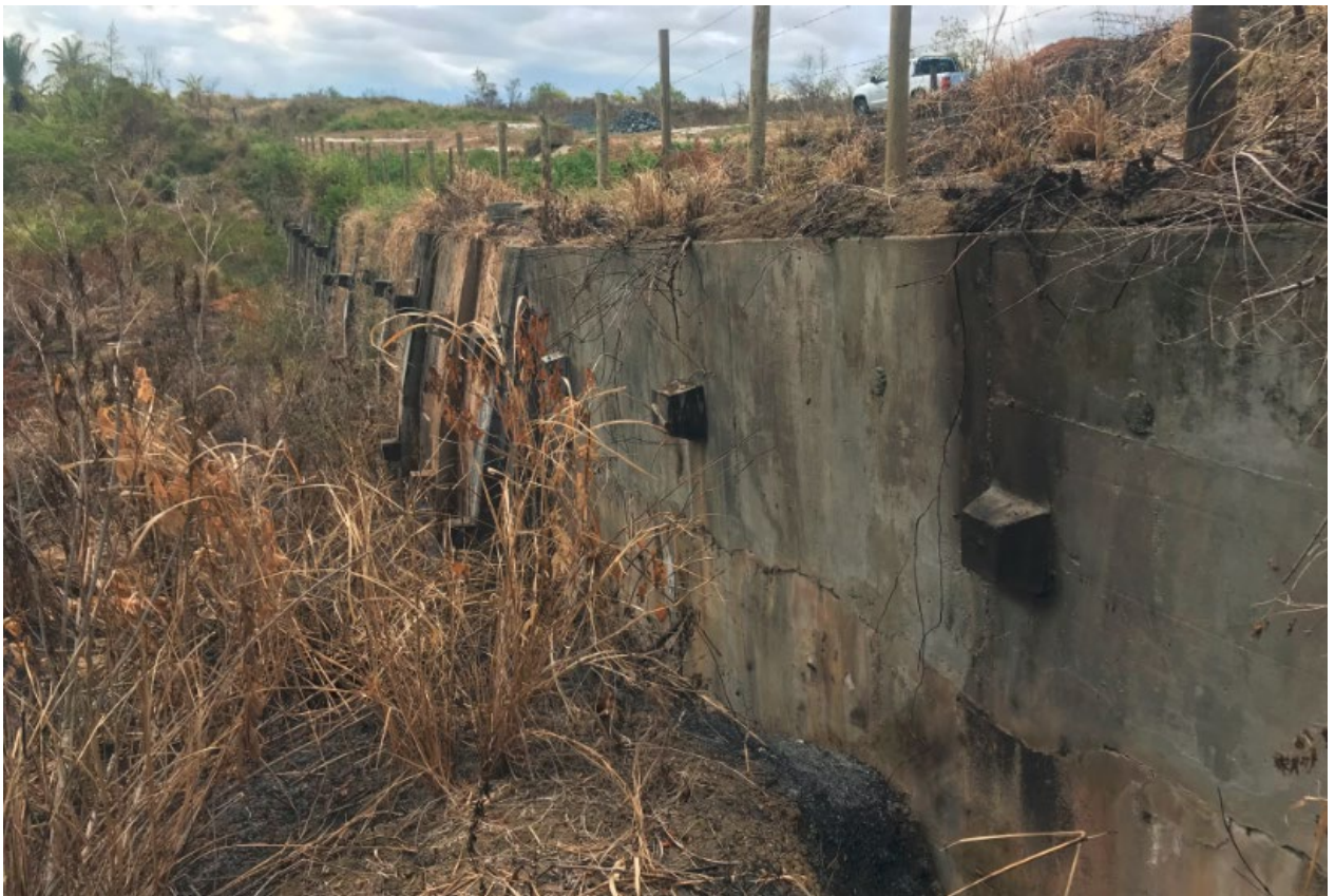
Figura 6.20 Contenciones en concreto con necesidad de tratamiento superficial y en juntas
