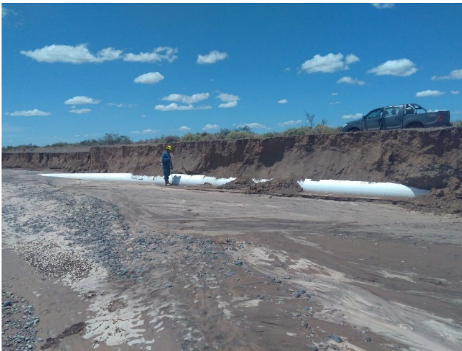
Figura 4.25 Corrimiento lateral de margen con ducto paralelo a la misma en un cañadón de un ambiente desértico de la Patagonia
