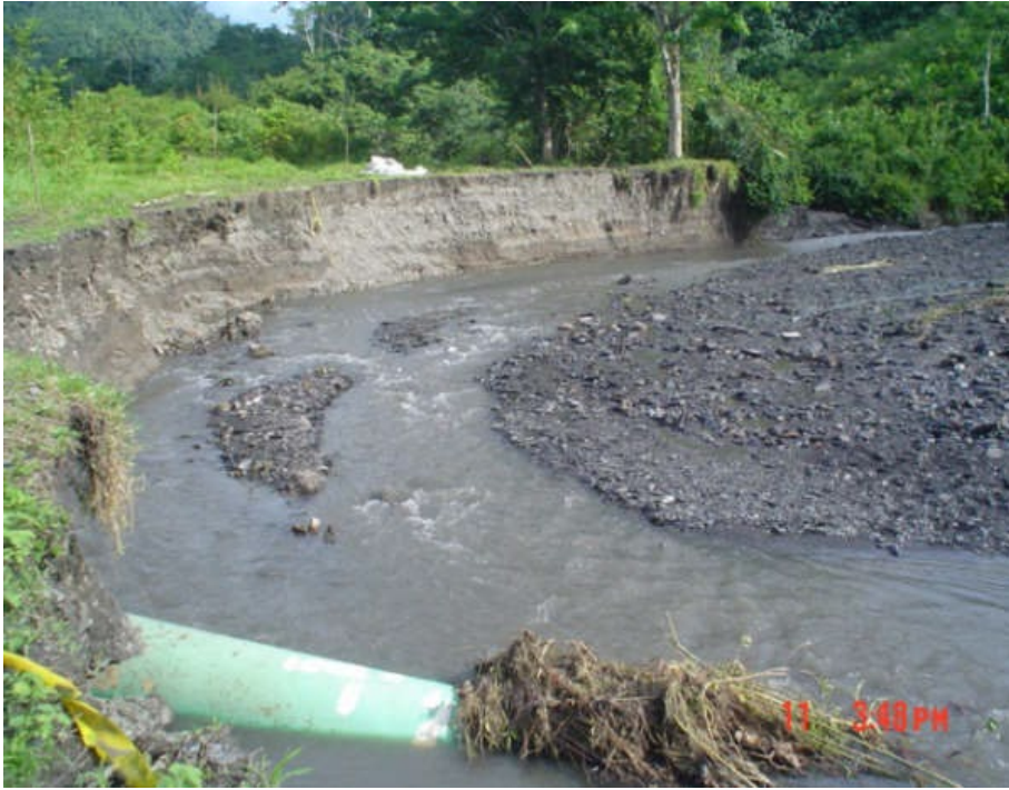
Figura 4.24 Socavación lateral que descubre bayonetas de ducto
