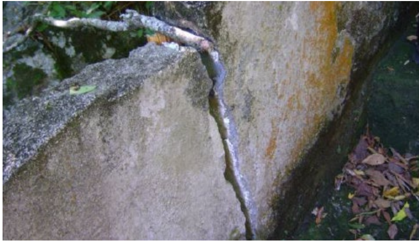
Figura 6.8 Lateral de canal que requiere reparación externa simplificada
