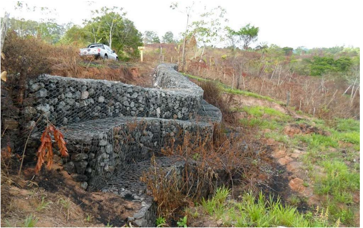
Figura 6.18 Falla de la estructura de contención
