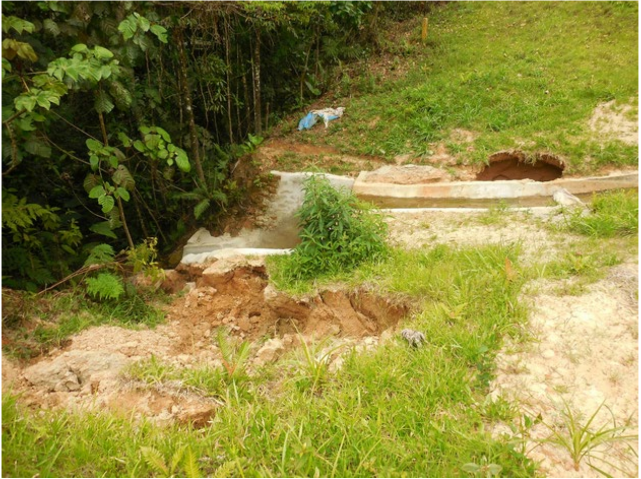
Figura 6.1 Drenajes dañados causando puntos de infiltración y erosión concentrados y preferenciales
