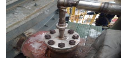
Punto de Inyección (Sparger)
